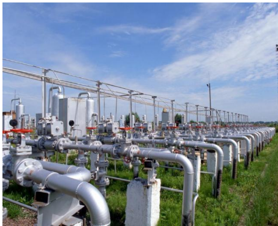
Hình 1.4. Đường ống cung cấp khí tự nhiên
